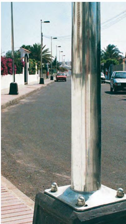
Figure B Este poste de alumbrado brillante de acero inoxidable tipo 316 ha estado en servicio por más de 10 años. Este substituyó al acero galvanizado corroído. (Fotografía Cortesía de Outokumpu)
