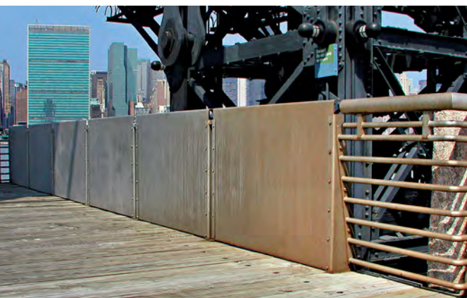
Figura C El acero inoxidable del tipo 316 ha funcionado bien en los muelles. La excepción es la zona de salpicado, donde hay una decoloración causada por el manchado de corrosión (lado derecho de la imagen).
