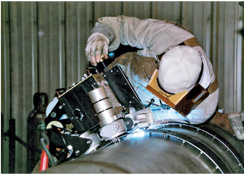
Soldagem automatizada de tubulação em aço inoxidável duplex de grande diâmetro na montanha norte de Alaska. © Arco Exploration and Production Technology
