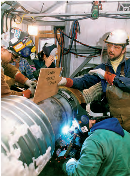
Soldagem mecanizada de uma tubulação de aço inoxidável duplex de grande diâmetro. © Arco Exploration and Production Technology
