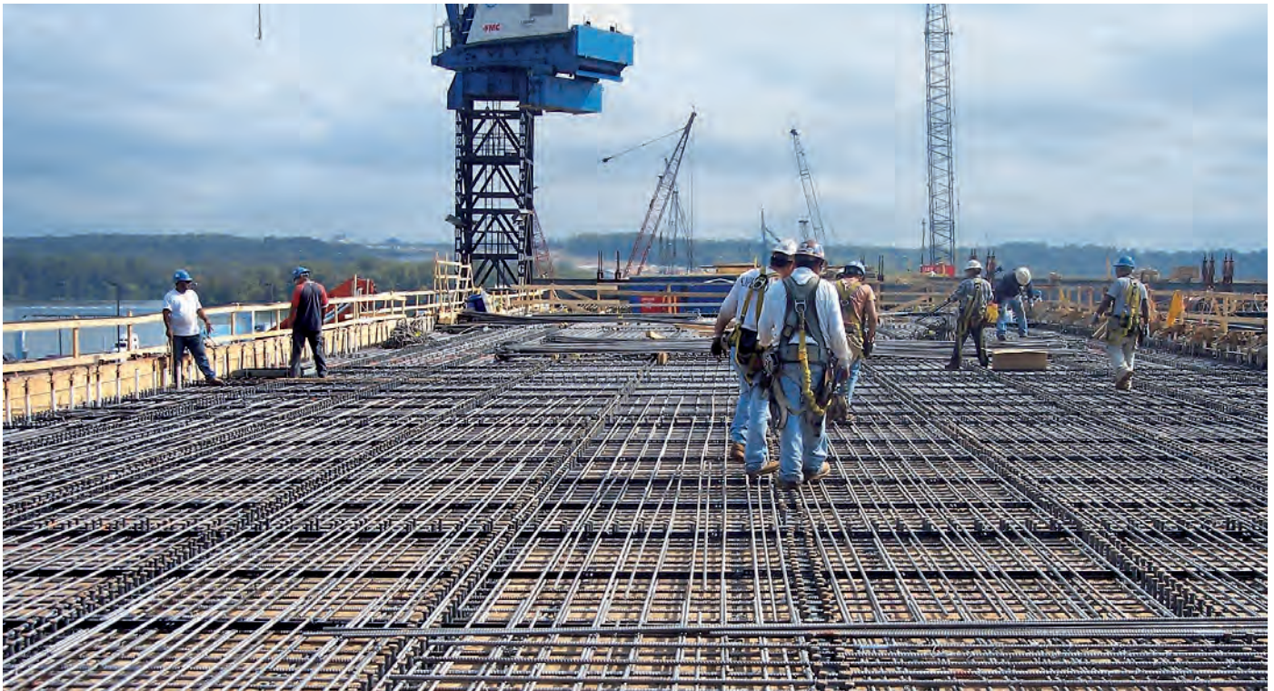
Instalação de vergalhão de aço inoxidável duplex em um amplo deck de ponte. © Hardesty & Hanover, LLP
