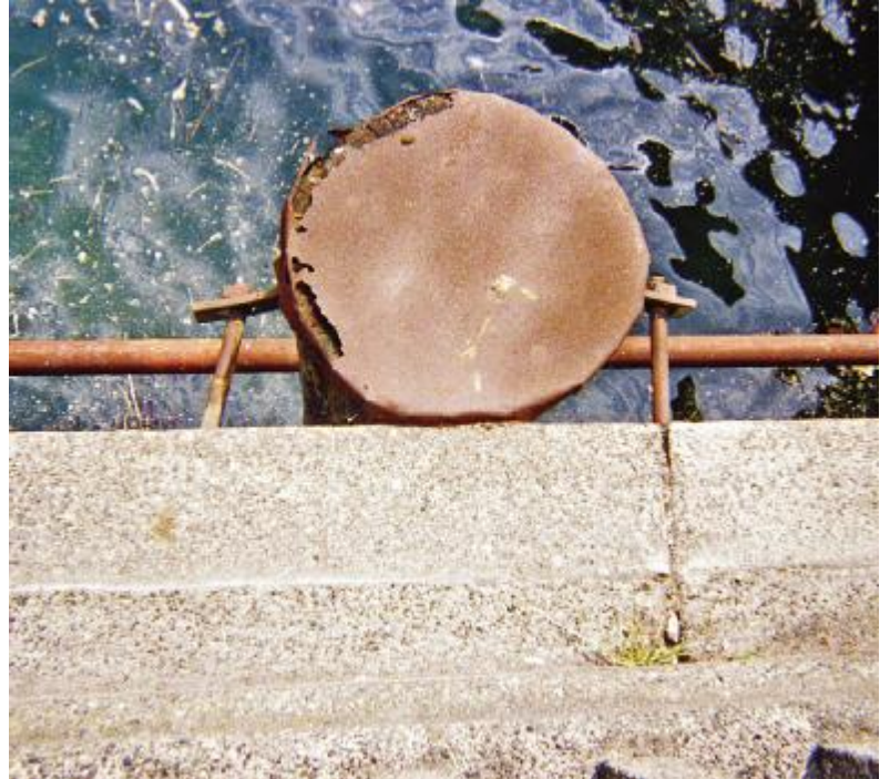
华盛顿州西雅图一个由碳钢制成的栈桥锚固系统发生严重腐蚀
