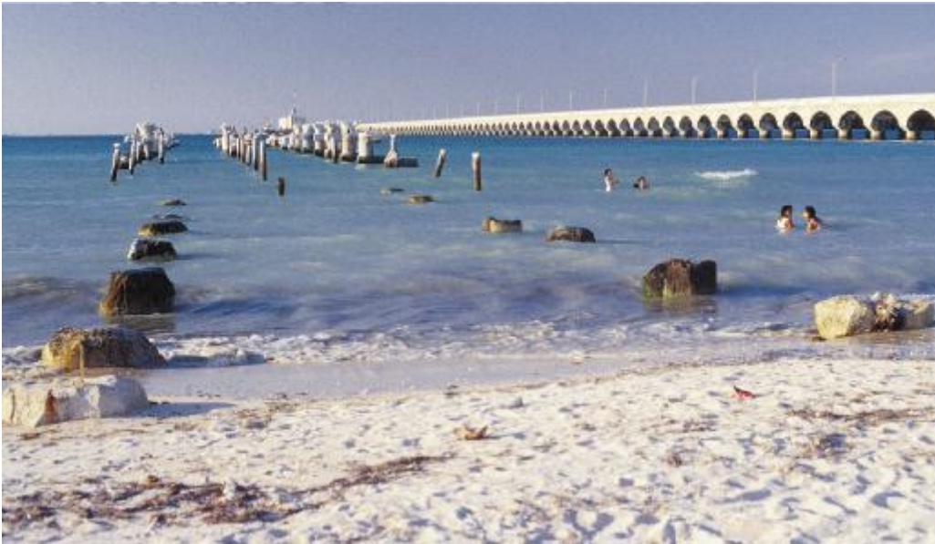
墨西哥普罗格雷索两个相邻的栈桥码头,显示了不锈钢和碳钢长期表现的差异。右后至今仍在使用的码头建于1941年,采用不锈钢钢筋建造,土芯试样显示不锈钢或结构没有发生损坏。旁边已完全损坏的码头是在1960年用碳钢钢筋建造的
