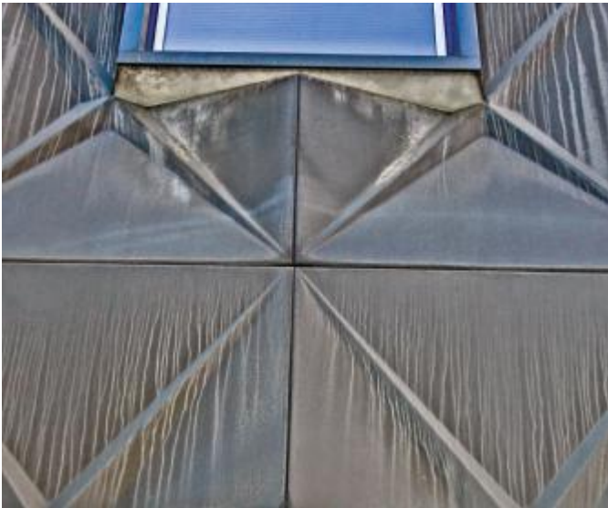
图 4：一幢办公楼第二层的阳极氧化铝板遭受除冰盐腐蚀
