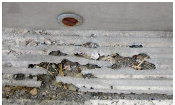
图 3: 除冰盐造成铝制门槛发生严重腐蚀
