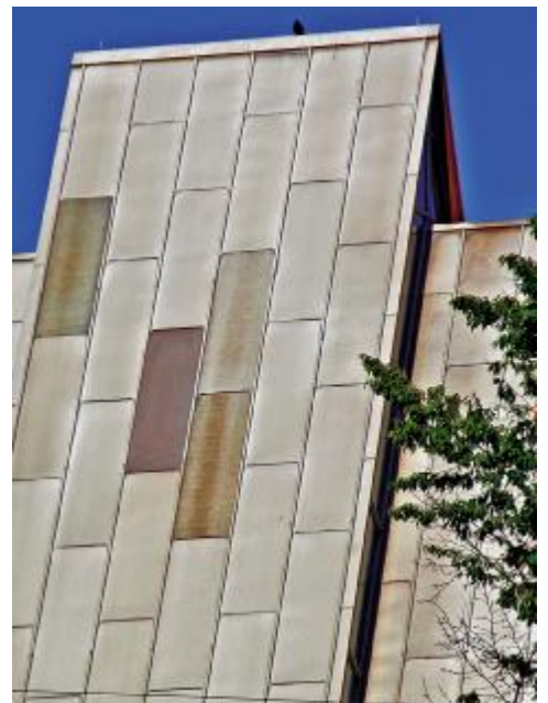
图 6：城郊一条四车道公路附近一座教堂的镀锌钢屋顶板发生腐蚀
